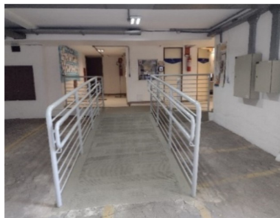
Rampas Acessibilidade JFO
