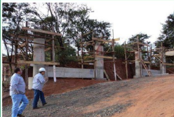
Foto – 01 – Viaduto sobre a BR/040 – Linha de Pilares – P5 a P8 lado direito da BR/040 sentido Rio de Janeiro
