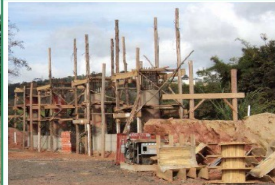
Foto – 02 – Viaduto sobre a BR/040 – Linha de Pilares – P1 a P4 lado esquerdo da BR/040 sentido Rio de Janeiro
