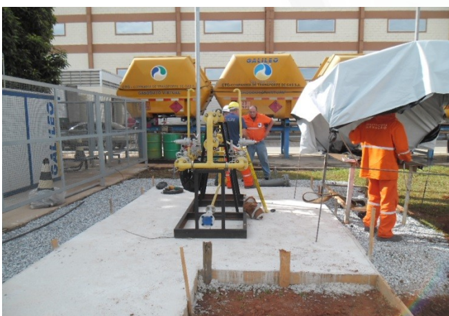
Instalação CMRP Sanobiol
