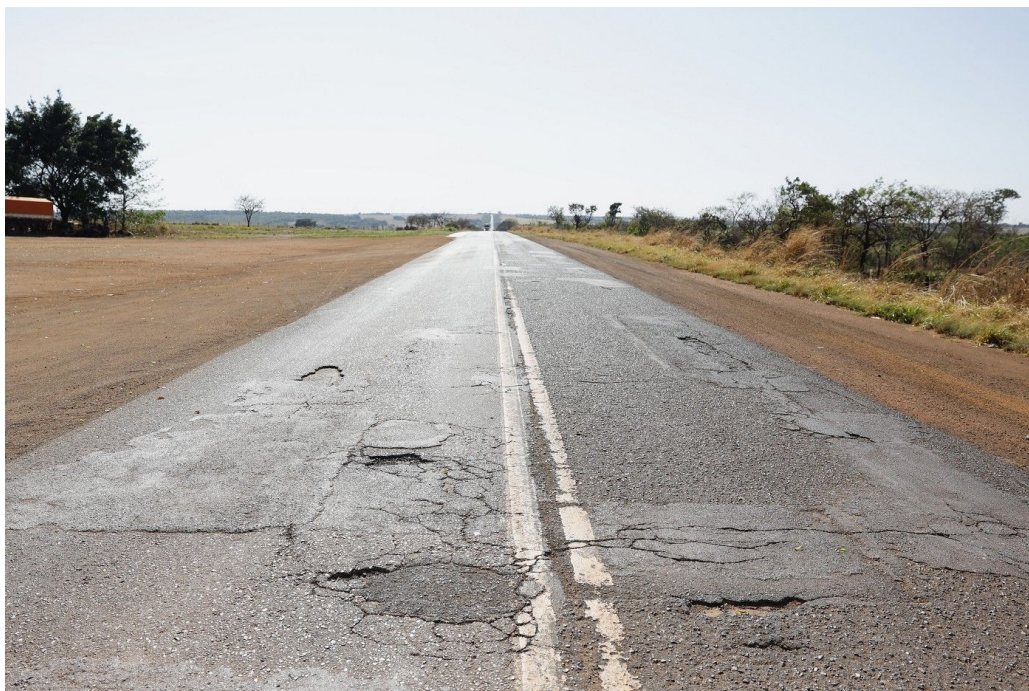
Figura 1 – Condições da MGC-452 na altura do Km 29
