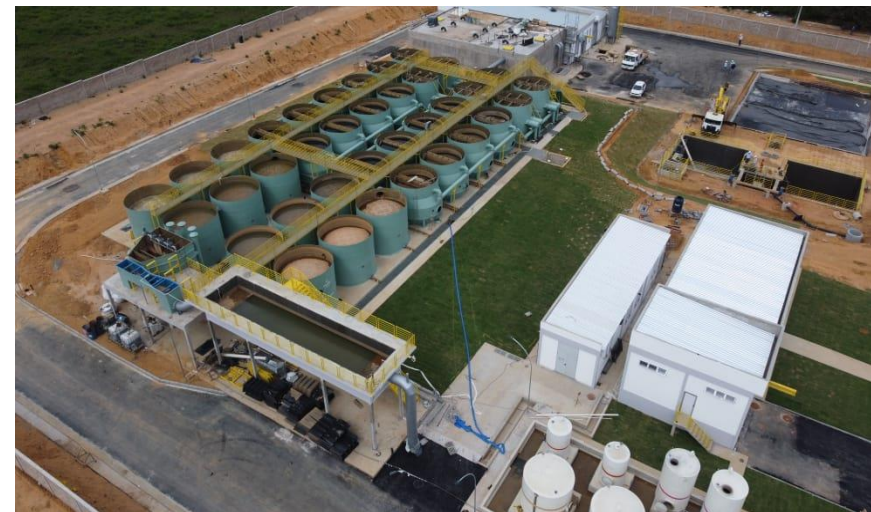
Captação de água em Ibiaí - adutora São Francisco
