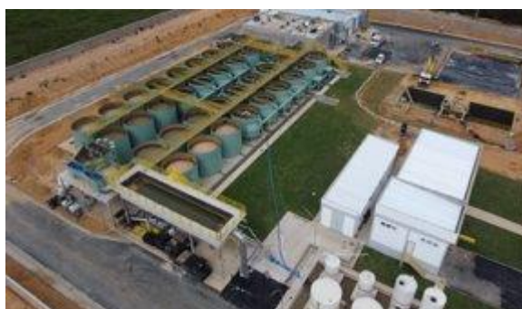
Figura 9: Captação de água em Ibiaí (adutora São Francisco)
