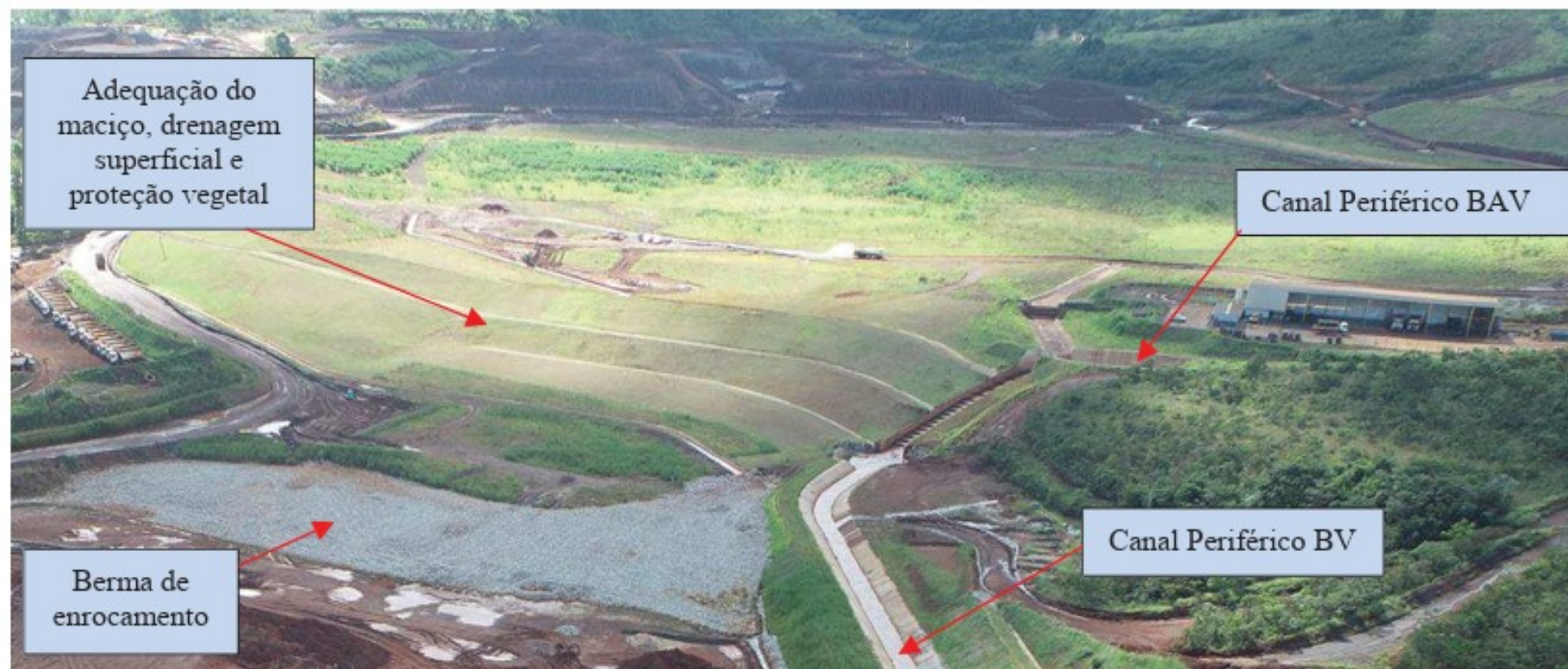
Fonte: Barragem do Vigia- 3º Relatório Trimestral de acompanhamento das obras de descaracterização- Nota técnica
