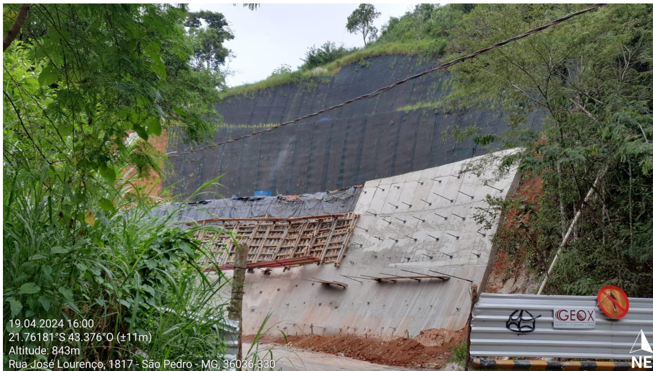
Figura 10 - Obra de contenção em área de risco geológico muito alto, sendo executada na Rua José Lourenço.
