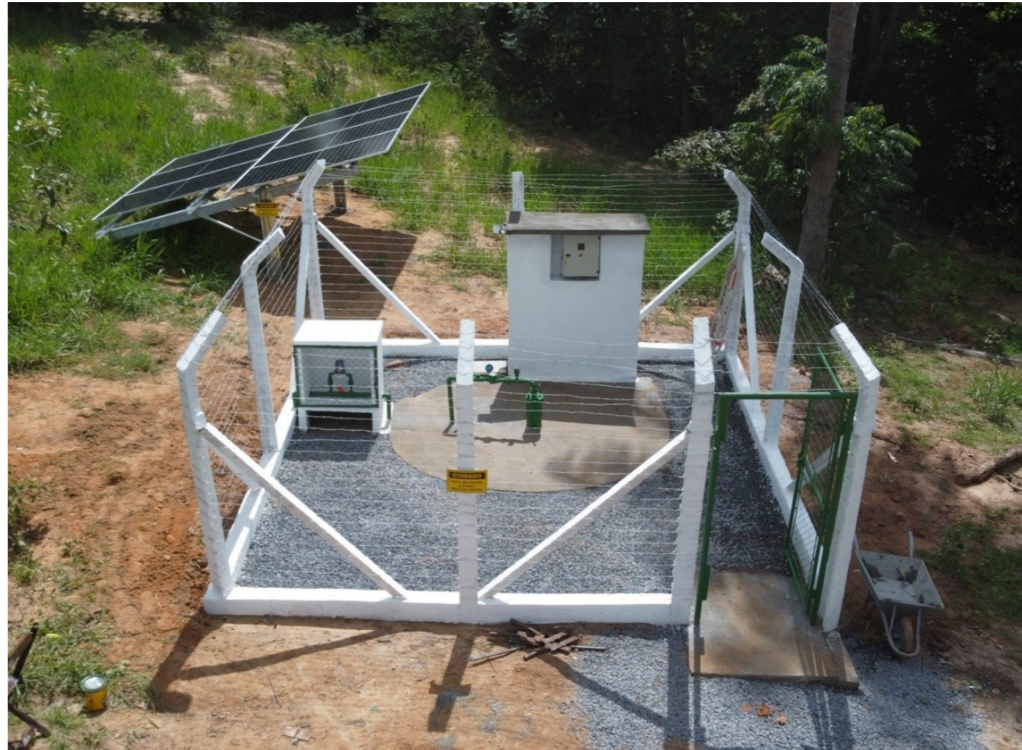
Sistema de Abastecimento Simplificado de Água – SSAA com o kit fotovoltaico.
